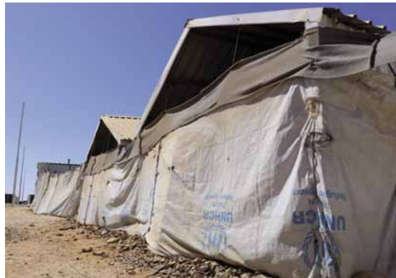
Přístřeší v uprchlickém táboře Azraq před renovací. Tábor se nachází na východě země v pouštní oblasti s výraznými teplotními výkyvy, silnými větry a pouštními bouřemi. Chatrné provizorní přístřešky nepříznivým vlivům počasí snadno podléhají. © MV ČR, foto: Jiří Pasz
